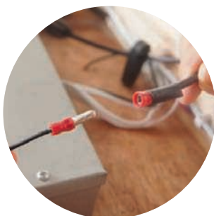
Ukázka propojení kabelů
