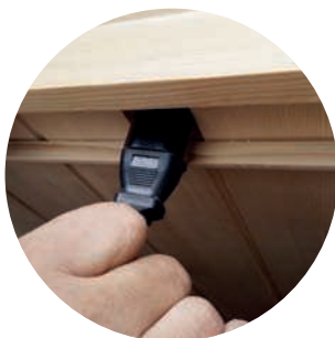
Ukázka protažení kabelů
