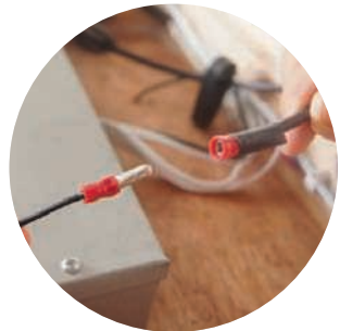
Ukážka prepojenie káblov
